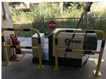
Station distribution de Gaz Naturel de Ville
